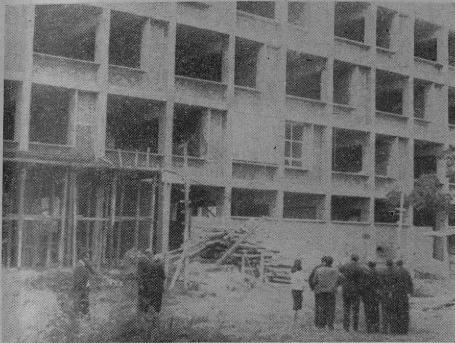
La estructura del edificio que alojará una Preparatoria en Tacubaya, está concluida. El Rector y algunos de sus colaboradores la visitaron el pasado 6 de diciembre.
