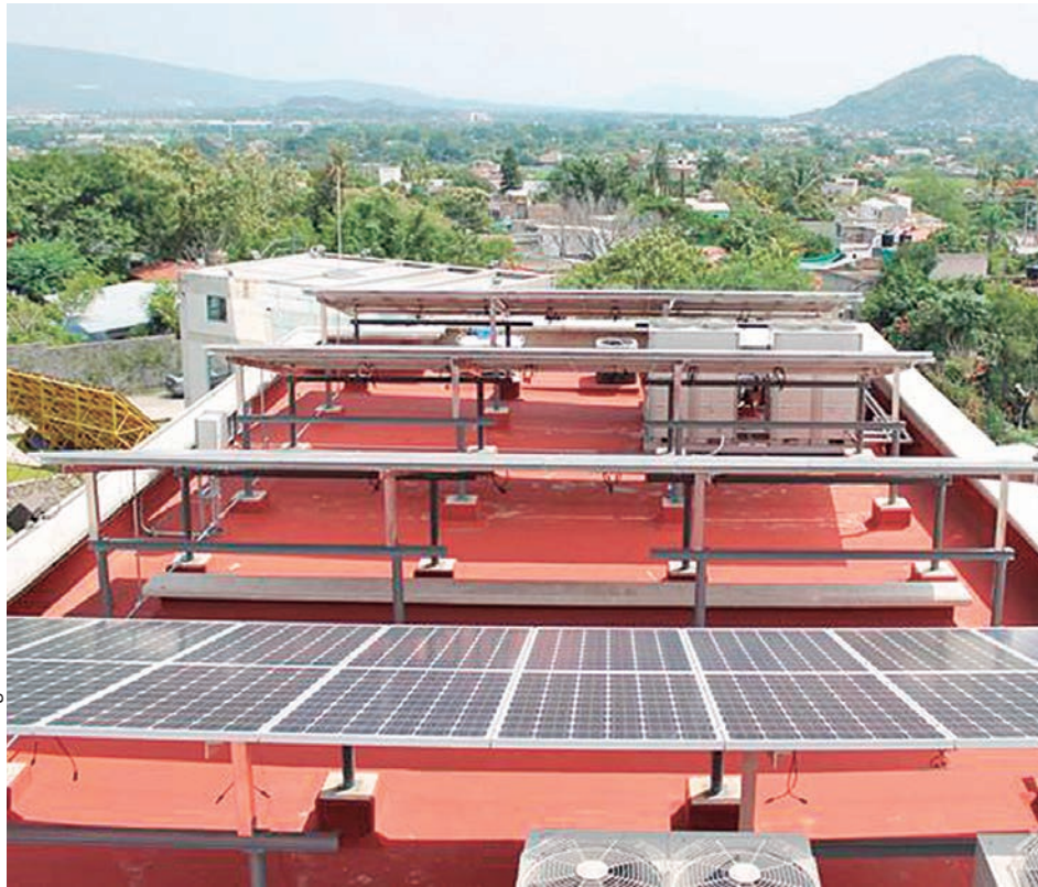
Foto: Instituto de Energías Renovables.
