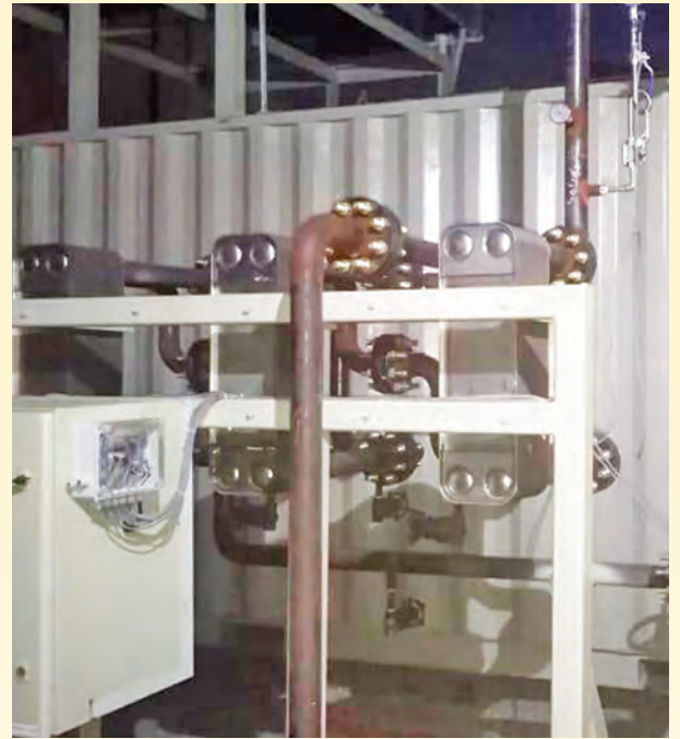
• Equipo de intercambio de calor trabajando de noche.
