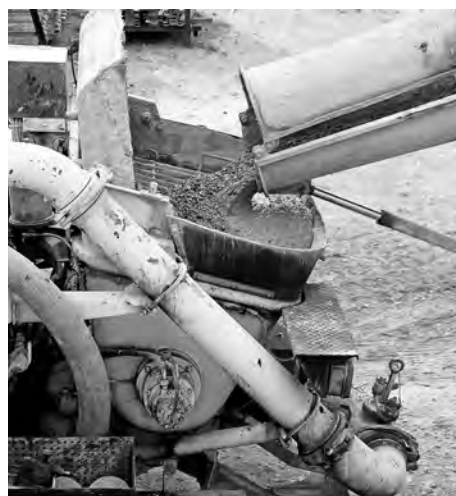
► En lugar de gravilla, agregan a la mezcla de cemento polietileno de alta densidad.
