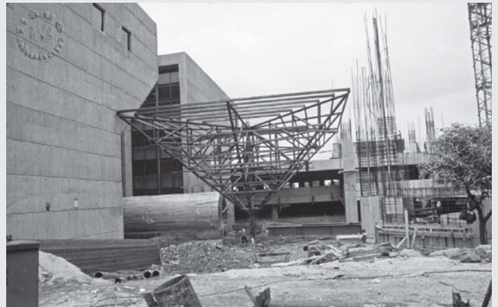
Construcción del Fondo Reservado de la Biblioteca Nacional, 1992. Foto: Vicente Guijosa. IISUE/AHUNAM/UNAM, Imágenes de Hoy , GV 066.
